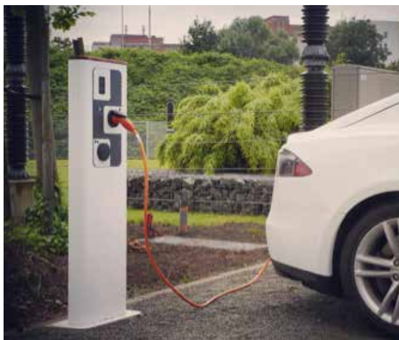
Mode 3 laadpunt (laadpunt voor buiten - Nextender dual laadpaal van Powerdale)
