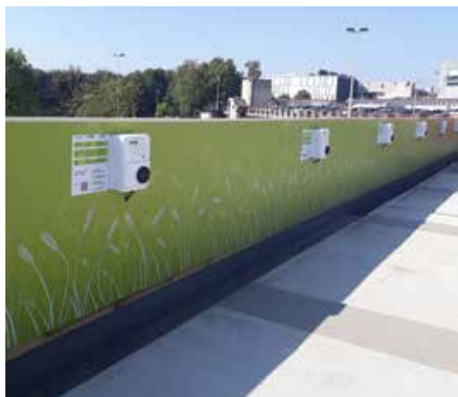
Points de recharge de mode 3 EV-point
